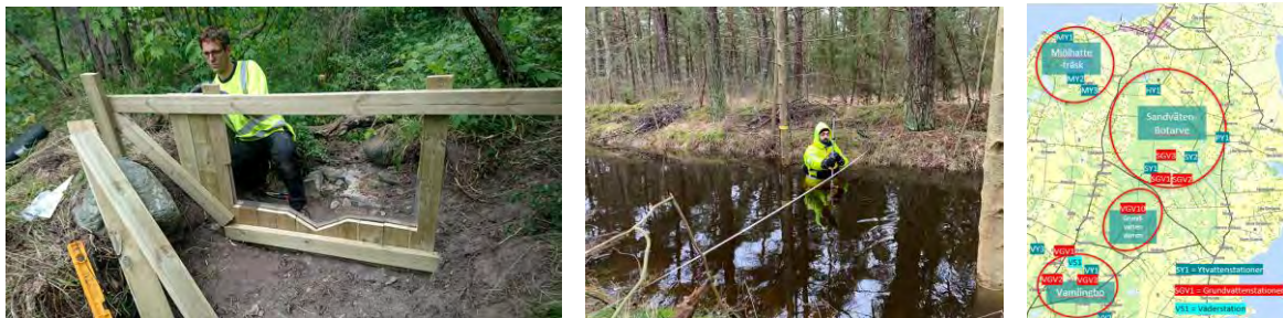
Figur 4a, b och c: Stephan Valley, IVL, installerar flödesmätutrustning i ett mindre dike och Shadi El Habash, Region Gotland, kalibrerar flödesmätare i det större Petesdiket. Placering av realtidssystemets infrastruktur framgår av kartan.
