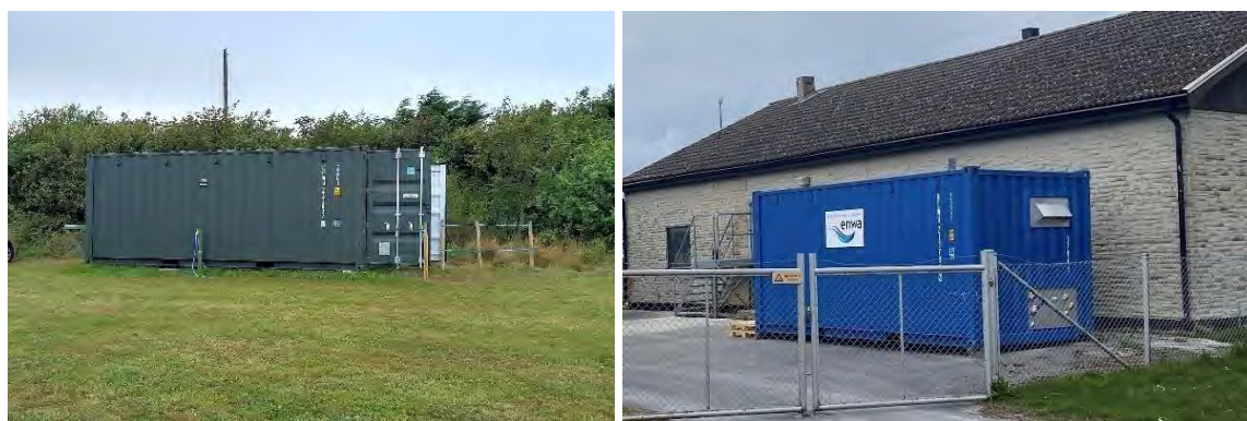
Figur 11a och 11b. En typisk installation för pilotcontainern. En inloppsledning från sjön går in i containern och en returledning går åter till sjön. För bevattningscontainern krävs också en ledning till området för bevattning. Utanför containern (en 20 fots container likt de på bilden) finns en 1 m 3 neutraliseringstank för tvättvatten. 9b: I väntan på tillståndet för vattenverksamhet står pilotutrustningscontainern uppställd utanför reningsverket i Burgsvik.
